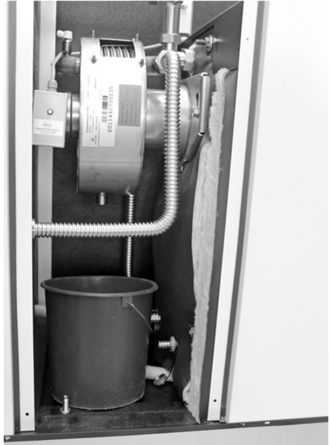
Abb. 70: Zur Reinigung vorbereiteter RWT
