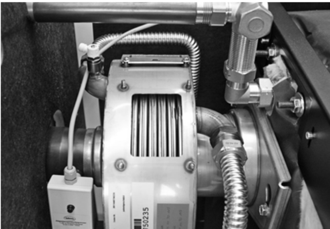
Abb. 69: Reinigungsöffnung des RWT
