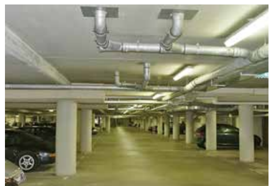
Individuelle Anschlüsse und Rohrsysteme
