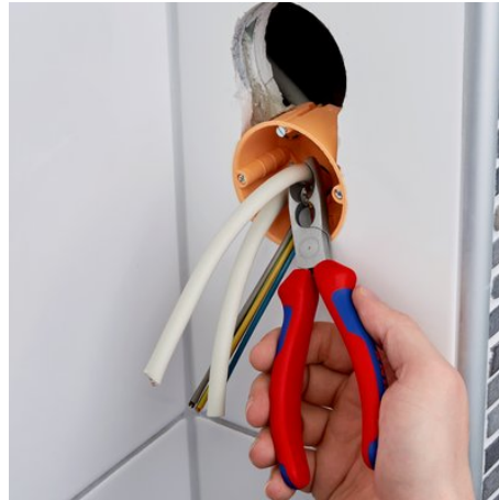
Abmanteln tief unten in der Unterputzdose
